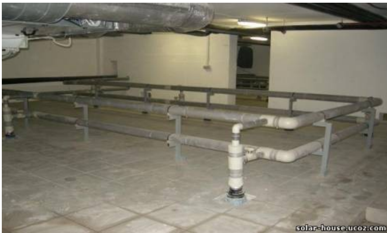
Сезонный грунтовый аккумулятор тепла в подвале дома
